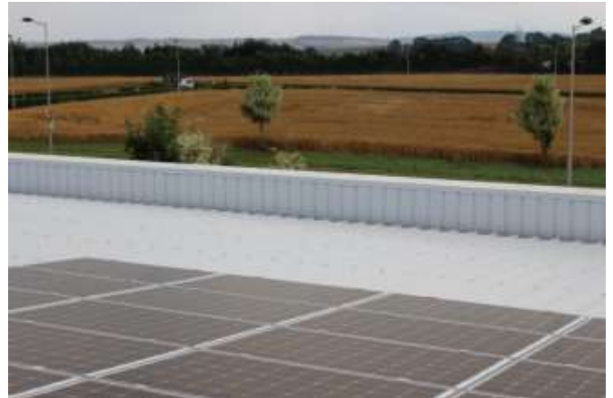
Projet photovoltaïque réalisé avec le soutien du SDEC Energie
