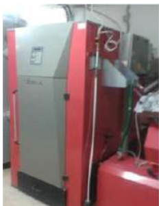
Chaudière de Dozulé
