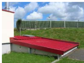
Silo enterré, chaufferie bois de Dozulé
