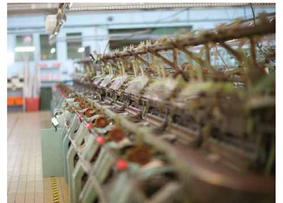
Fig. 26 Photographie de la salle des machines de l'usine textile SAS Bernard Philips. Villers-Bocage. Source : Calvados Tourisme.
