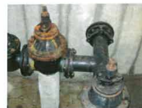
Chambre des vannes
