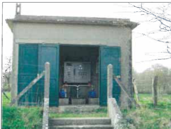
Photo 2 : Station de reprise de la Seinière
