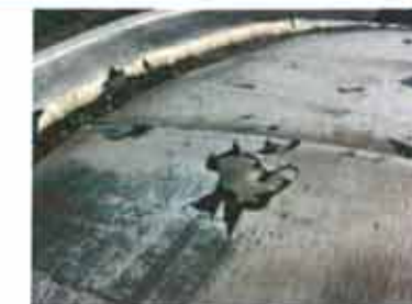
Dégradation du toit
