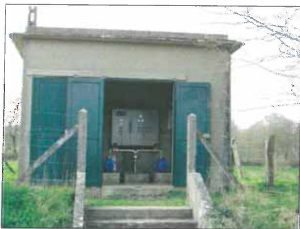
Photo 2 : Station de reprise de la Seinière
