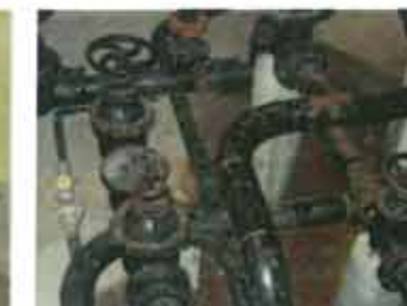
Chambre des vannes
