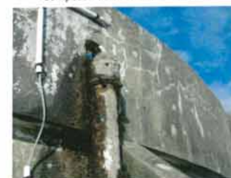
Raccord gouttière cassé
