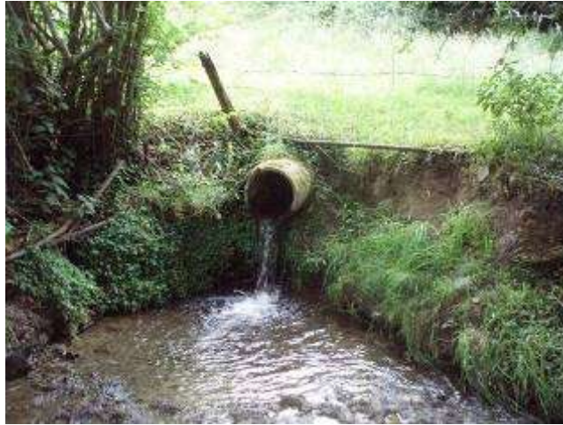
Figure 5 : Exemple d'ouvrage calé trop haut par rapport au niveau du cours d'eau aval
